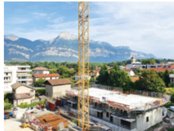
La résidence Le Kalysto, en construction par la SDH en 2023 à Villard-Bonnot (38).
