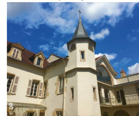
À Dijon (21), réhabilitation en cours du Foyer de la rue Saumaise ( Habellis ).
